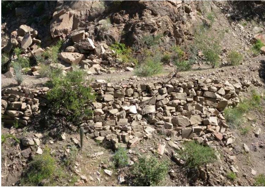
Figura 8.- Estado actual de una pared de contención, cuya función es impedir corrimientos del firme (tramo del Camino Real Misionero) (Fuente: fotografía de los autores).
